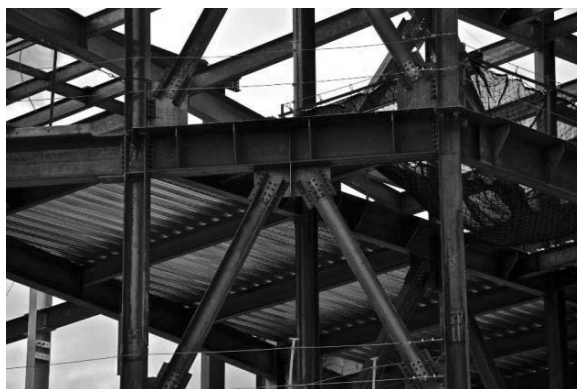
Figure 8 : vue inférieure d'une dalle mixte coulée sur une tôle nervurée. Photo de Orest Ukrainsky
